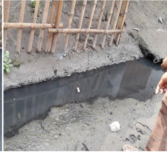
h) Broken drains
